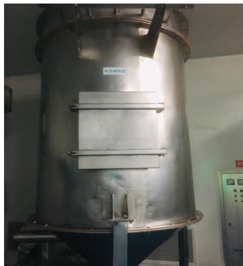
固体制剂车间破碎机布袋除尘吕
