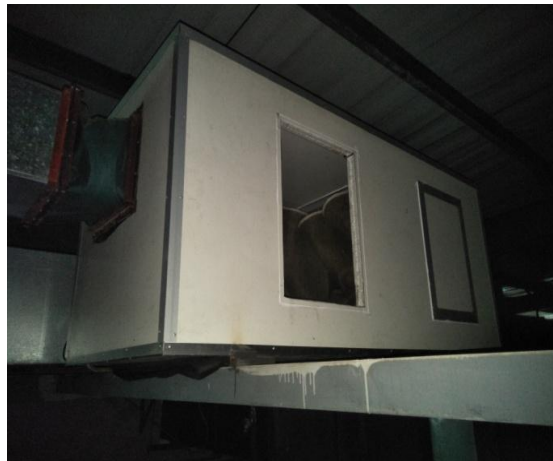
固体制剂车间室内空气处理机
